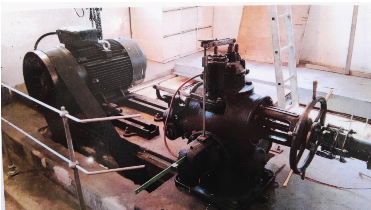
Současný stav strojovny-vlevo alternátor MEZ, vpravo regulátor turbíny
