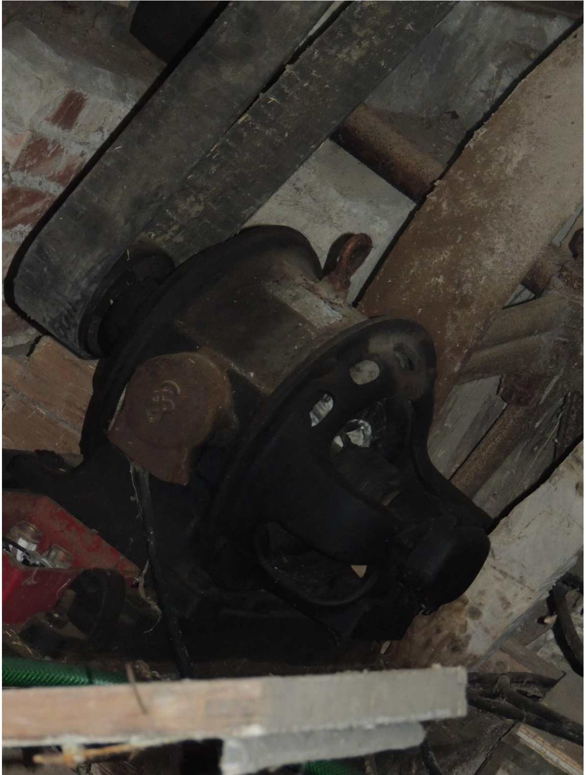
Detail hnacího kroužkového asynchronního motoru Siemens Schuckert, který nahradil pohon vodním kolem. Vedle je vidět řemenice, která zajišťovala pohon hřídele na půdě od vodního kola původně před vestavbou tohoto motoru
